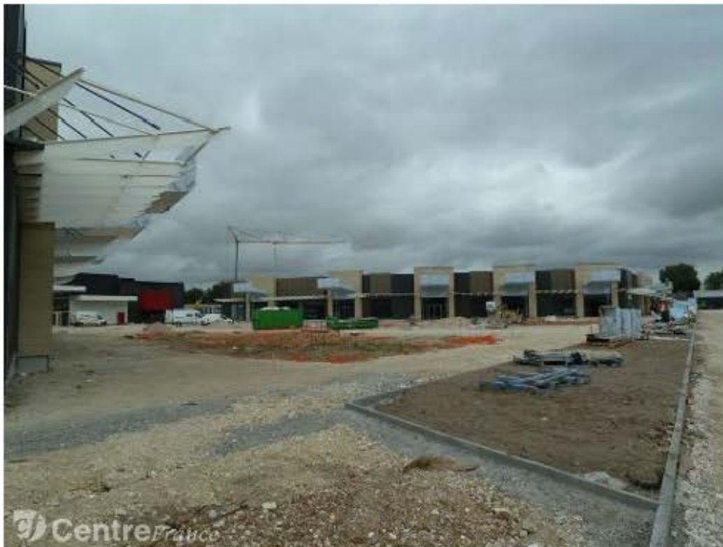
Une trentaine d'enseignes vont s'installer dans la nouvelle zone commerciale Champbertrand. Le chantier se termine. - RICHARD Olivier
